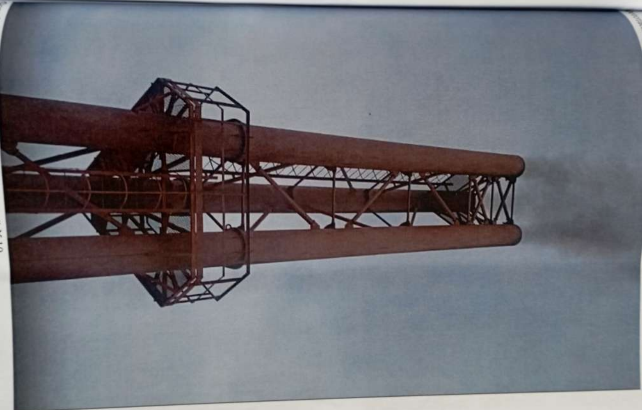
Котельная №2. Источники выброса загрязняющих веществ в атмосферный воздух
